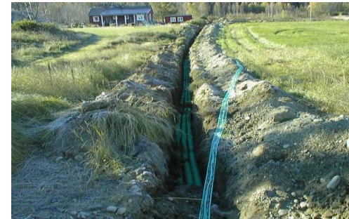
All kanalisation skall ha ett märkband
